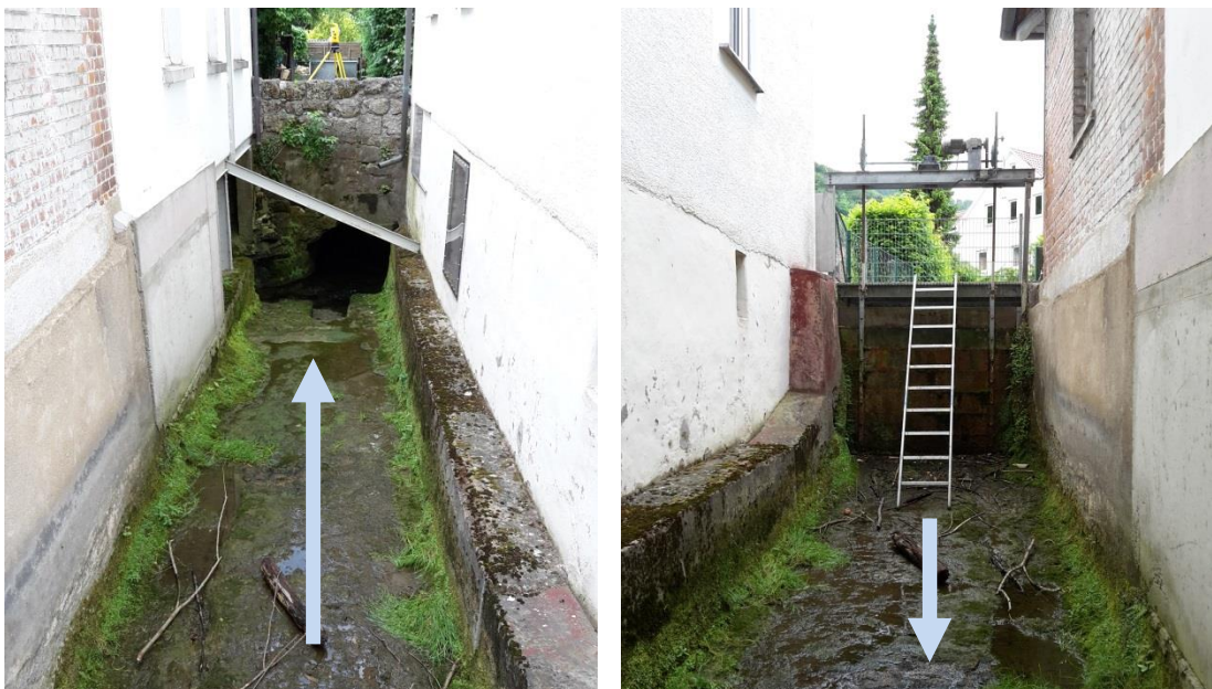
Fritz Planung GmbH – T12 Entlastung, Blick auf Verdolung (Links), Blick auf Einlaufschütz (Rechts)
